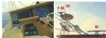
左:取材艇(Night & Day)(プレイカース61)のヘルムステーション周り、ナブネット3Dのネットワークを築き、大型のディスプレイを2基設置している。右:AISを使用するためには、GPS①とVHF②のアンテナを設置する必要がある。③はレーダーのアンテナ
